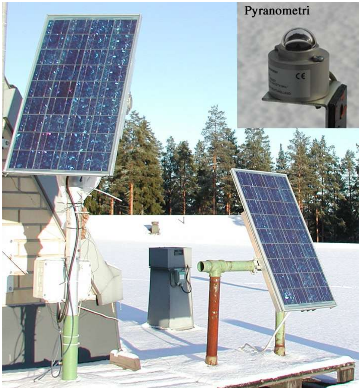
Kuva 1. Aurinkopaneelien sijainti mittausten aikana ja auringon säteilyn mittaukseen käytetty pyranometri.
